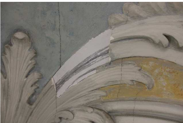
Figura 8 – Lacuna volumétrica nos elementos decorativos em estuque, bem como a presença de fissuras e fraturas.
