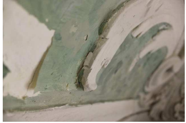
Figura 9 – Friabilidade causada pelas fluorescências salinas, com conseqüente destacamento das camadas de policromia e dos elementos decorativos.
