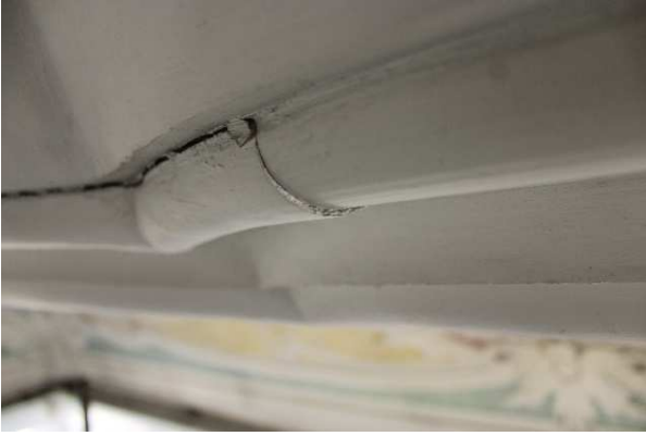
Figura 7 – Elemento fraturado, com risco de queda.
