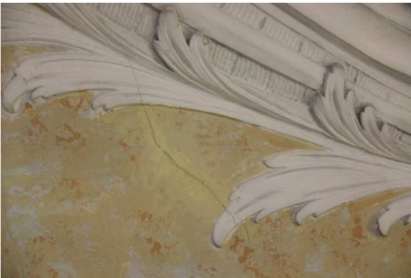
Figura 12 – Preenchimento de fissura executada com massas de composição desconhecida, seguido de reintegração cromática desajustada, resultantes de intervenção anterior.
